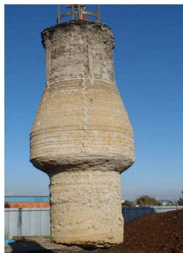
写真-1 掘り出したMe-A杭
