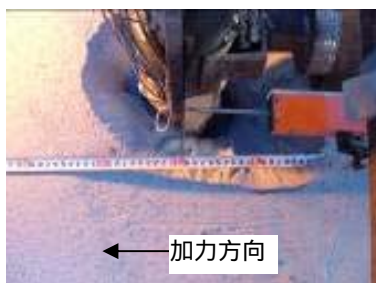
写真1 通常杭の周辺地盤
