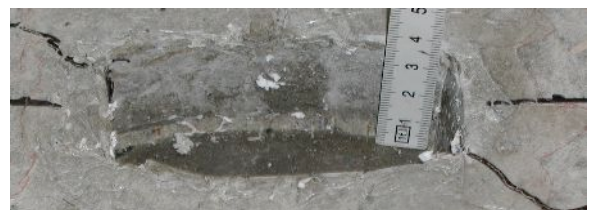
写真-1 支圧板直下のコンクリートめり込み (No.3)
