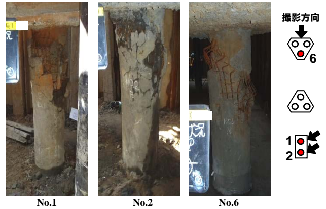
写真1 杭頭の破損状況 (杭 No.1,2,6)
